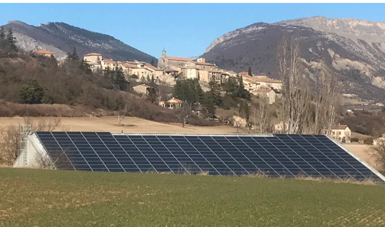
Toit de panneaux photovoltaïques à Lagrand _Cittànova
