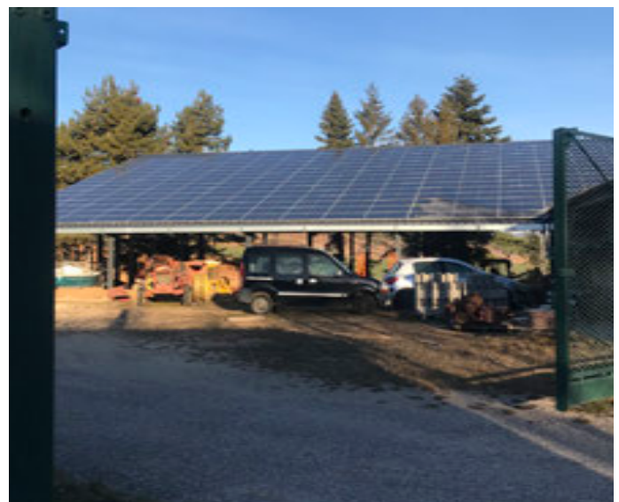
Toit de panneaux photovoltaïque sur hangar agricole à Mison_Cittànova
